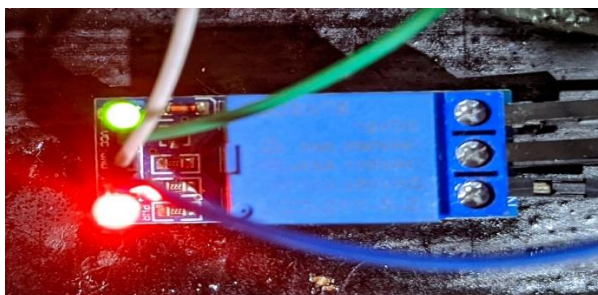
Gambar 15. Relay LED Hijau Hidup Menandakan Bahwa Pompa ON
