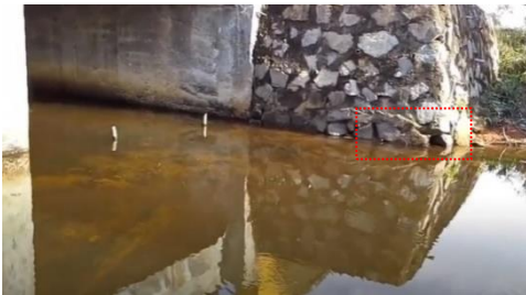
Gambar 7. Adanya Gerusan Lokal di Sekitar Abutment.
