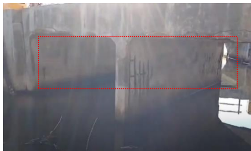
Gambar 8. Terdapat Tulangan yang Sudah Terbuka Pada Gelagar dan Pilar.
