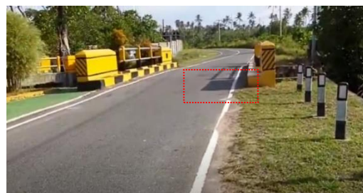
Gambar 6. Kondisi Lantai Jembatan yang Bergelombang
