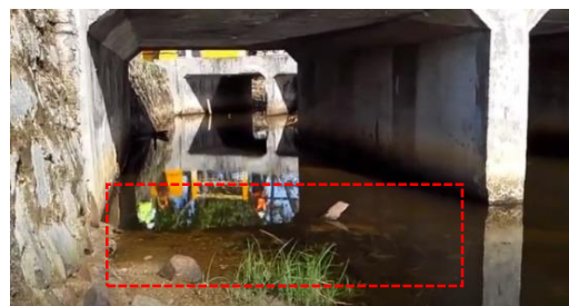
Gambar 9. Tampak Aliran Air Sungai yang Sangat Tenang/ Cenderung Tidak Mengalir
