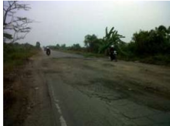
Gambar 2. Kondisi Jalan Menuju Kawasan Tanjung Api-Api
