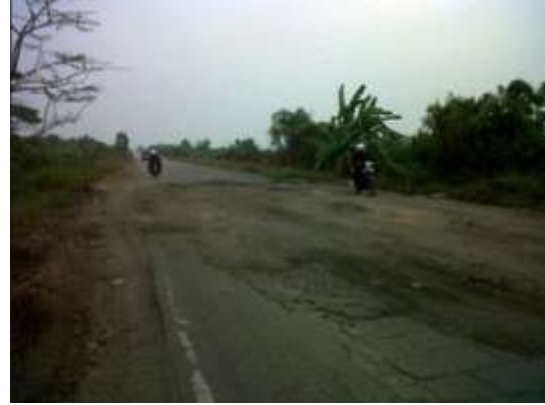
Gambar 2. Kondisi Jalan Menuju Kawasan Tanjung Api-Api
