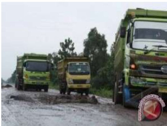
Gambar 1. Kondisi Jalan Menuju Tanjung Api-Api yang Dilalui Truk Bertonase Tinggi (Sumber : Antarasumsel.com)
