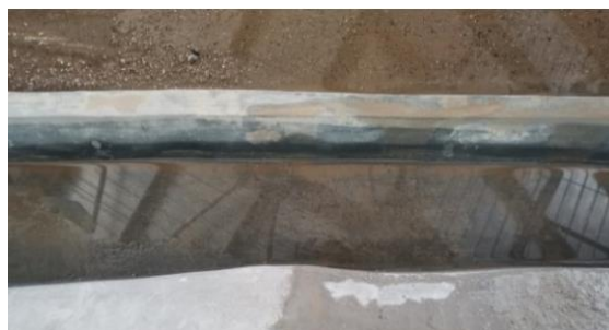
Gambar 29. Distribusi Pengendapan Sedimen di Sisi Tengah Saluran Memanjang pada Kondisi 5 dengan Debit Aliran 600 m 3 /detik
