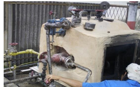
Gambar 3. Burner, Inlet Line Fuel dan Udara
