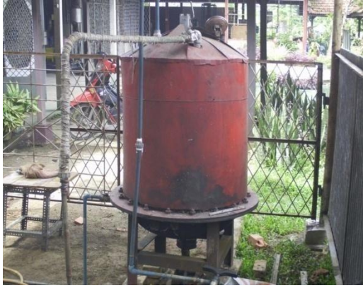
Gambar 7. Steam Drum Storage untuk Injeksi Steam pada Burner
