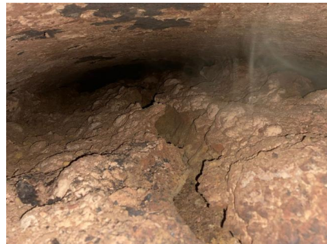
Gambar 5. Penumpukan material pada sisi dalam pipa ducting
