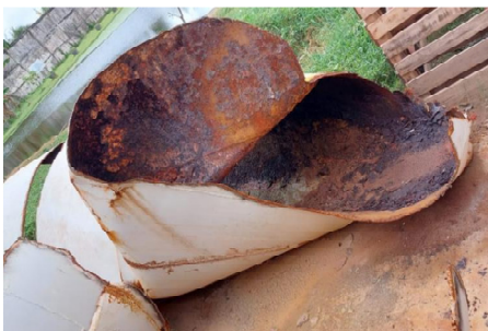
Gambar 4. Kegagalan bagian atas Cooler Cyclone dan bagian atas Cooler Pool Scrubber
