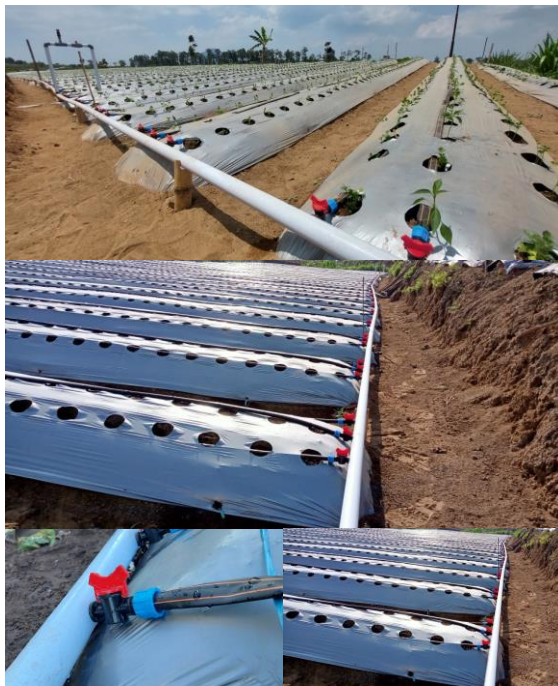
Gambar 8. Instalasi Jaringan Irigasi Tetes Terpasang
