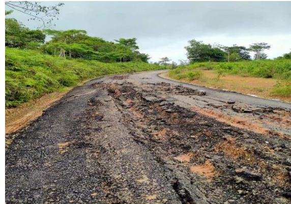
a. Lapisan pondasi tidak terpasang
