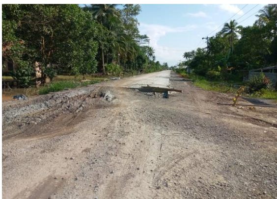
Gambar 3. Kondisi Jalan Jaya-Sumber Marga Telang
