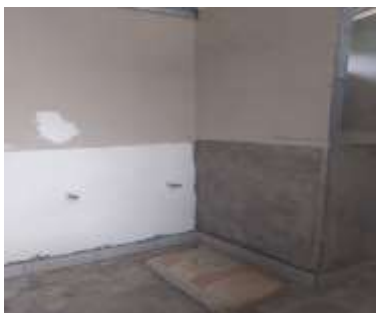
b. Dinding yang belum dikeramik dan saluran air belum terpasang
